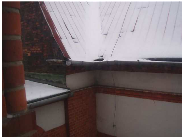
foto /30/ Pohled na podokapní žlaby, je viditelná jejich deformace
