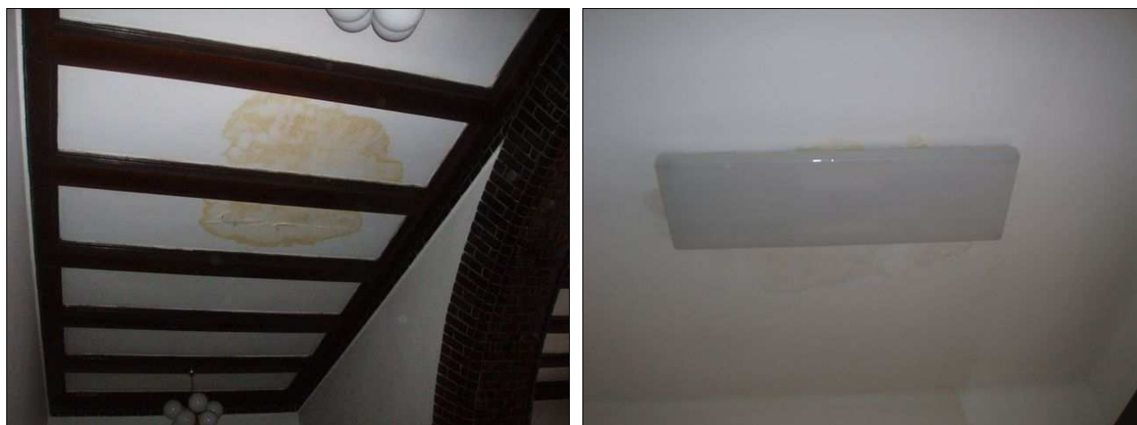
foto /2/ Vlhkostní poruchy – střední část, ochoz nad foto /3/ Vlhkostní poruchy – levé křídlo u kanceláří vstupním schodištěm
