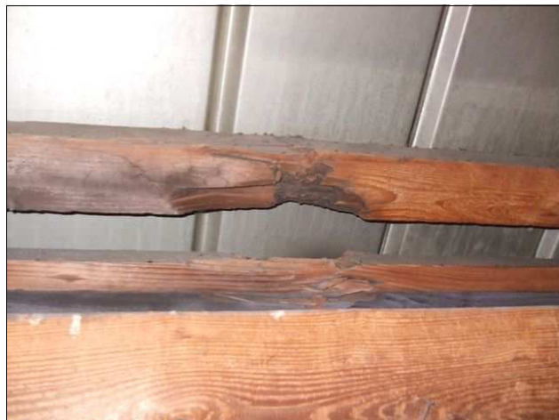
foto /26/ Ojedinělé lokální poškození střešní latě v pravém křídle objektu
