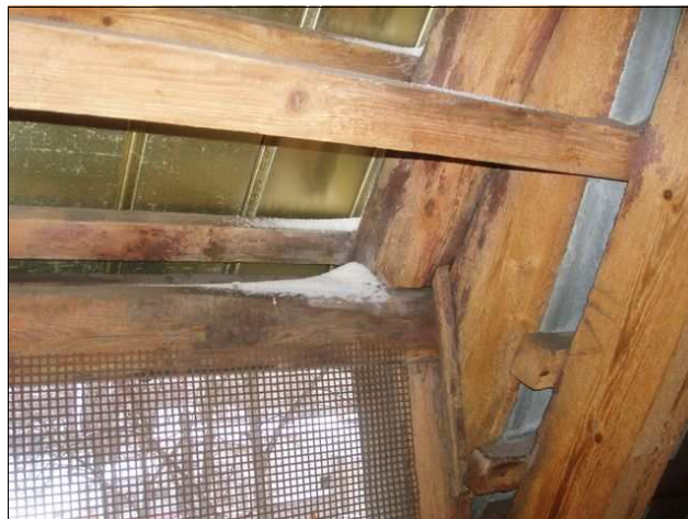
foto /22/ Nafoukávání prachového sněhu netěsnostmi ve střešní krytině do půdního prostoru
