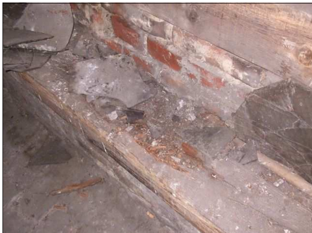
foto /25/ Lokální značná degradace pozednice pod vaznými trámy v místě pod výlezem na plochou střechu v levém křídle objektu – jedná se o ojedinělý případ, degradace vlivem zatékání výlezem
