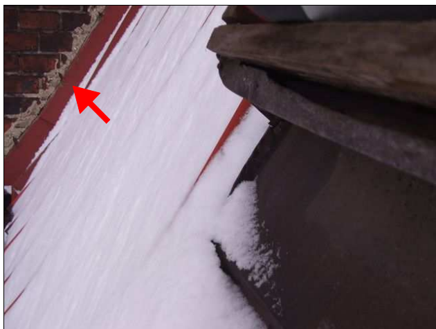
foto /23/ Ukončení plechové krytiny na přiléhající stěně z neomítaného zdiva, kotvení provedeno ocelovými skobami
