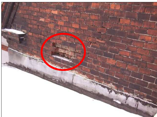
foto /19/ Napojení hydroizolace ploché střechy na navazující stěnové konstrukce, zakroužkováno lokální poškození zdiva
