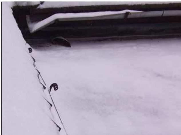
foto /29/ Pohled na viditelně zdeformované podokapní žlaby nad plochou střechou, pohled na ozdobné okapové háky
