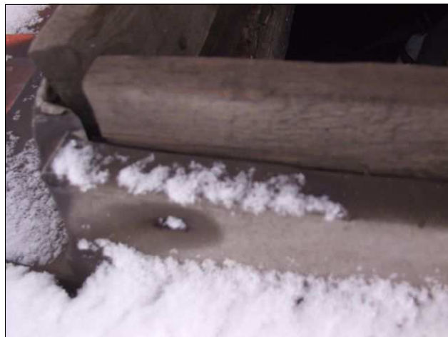
foto /18/ Dřevěné lemování výlezu – pohled z vnější strany, značně porušené, včetně klempířského lemování
